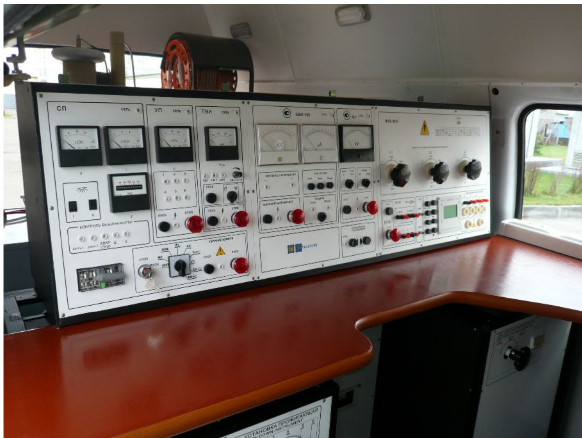
Вид на пульт управления в отсеке оператора кабельной лаборатории ЛВИ НVT-20FG
