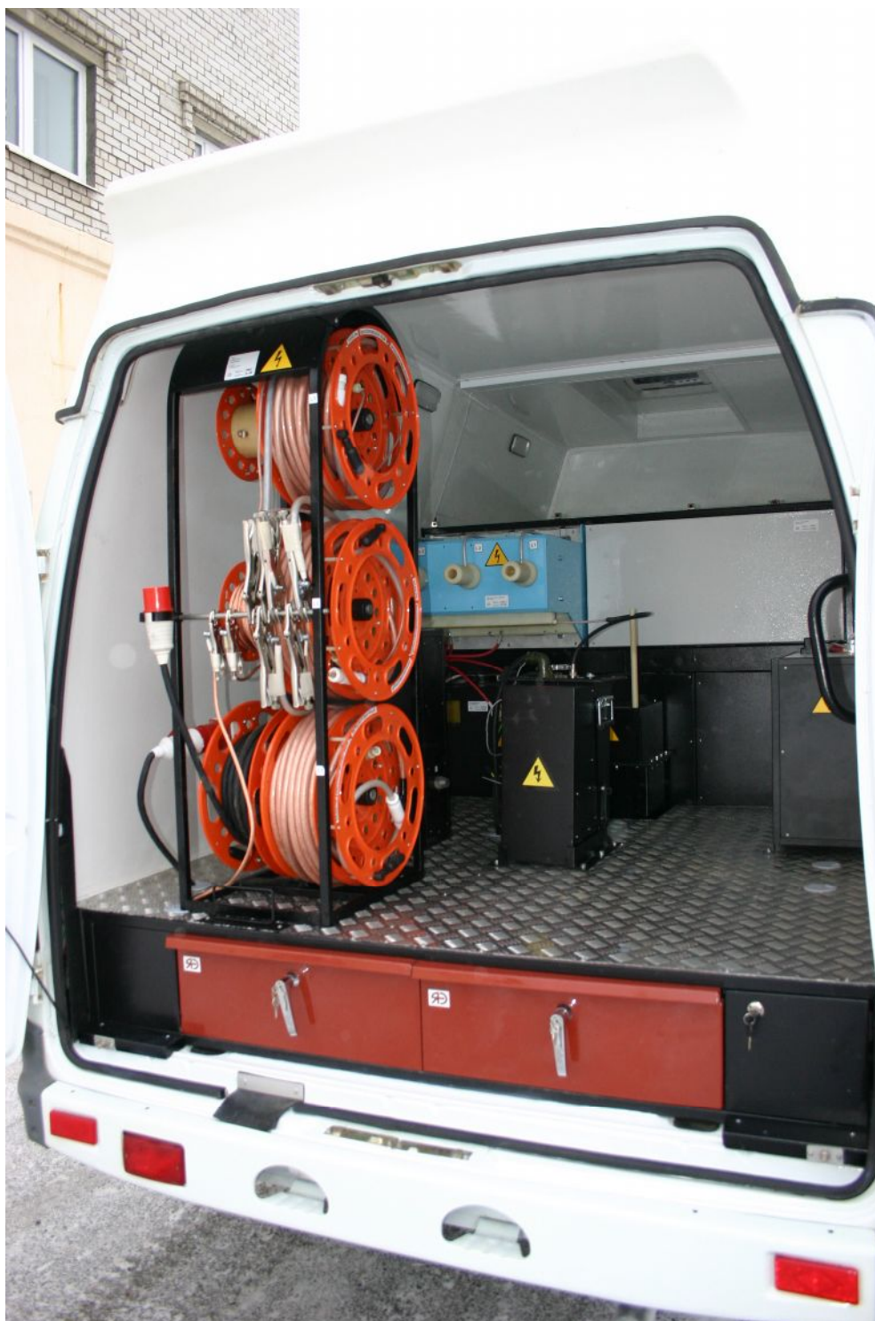
Вид на высоковольтный отсек кабельной лаборатории ЛВИ HVT-25FV
