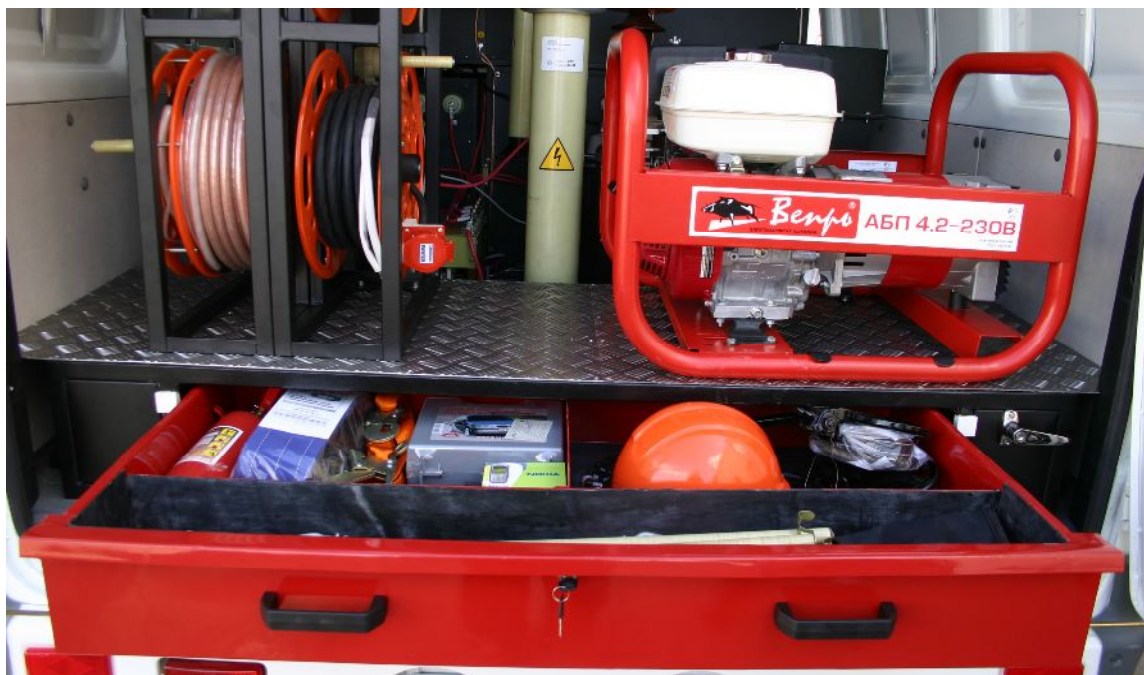
Виды на высоковольтный отсек кабельной лаборатории ЛВИ НVT-50FVG
