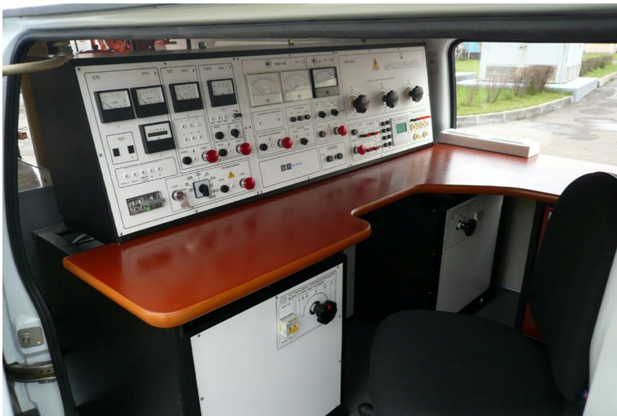
Вид на пульт управления в отсеке оператора лаборатории ЛВИ НVT-3F
